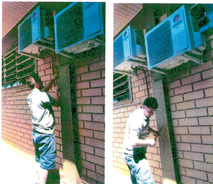
Manutenção de ar condicionado e conserto dos canos de saída de água
