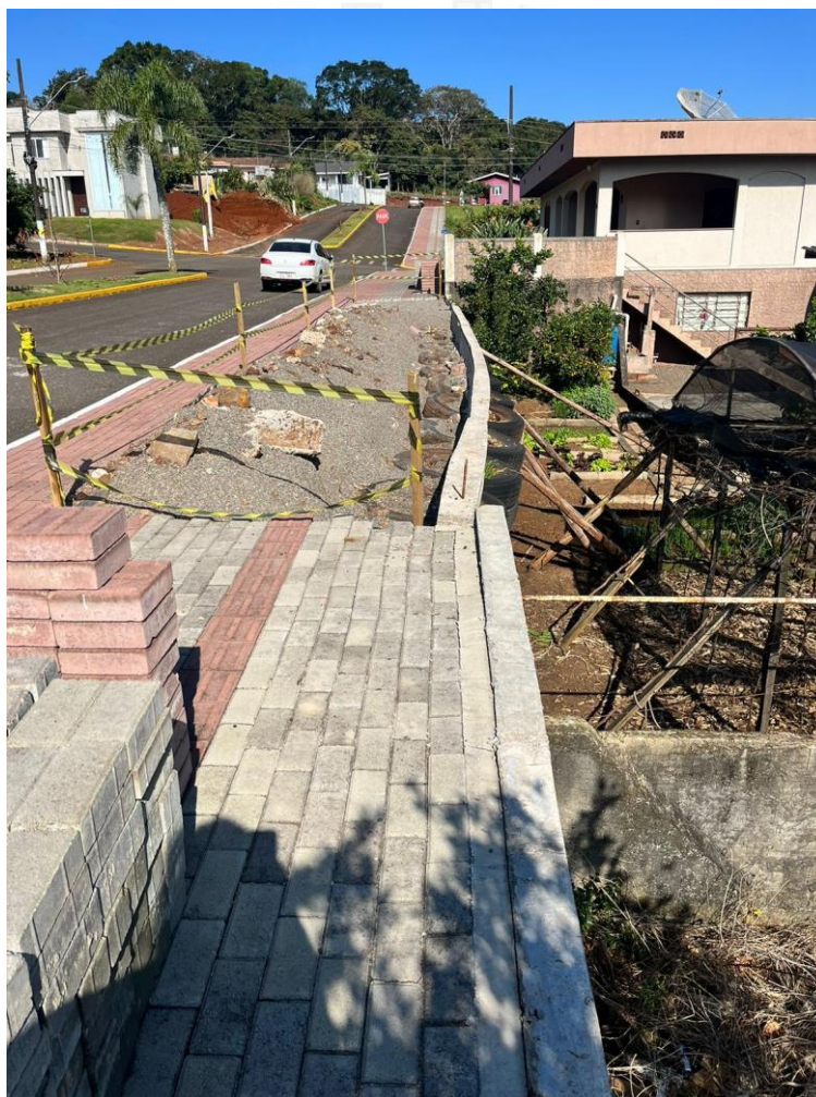
Figura 01: Situação atual do muro
