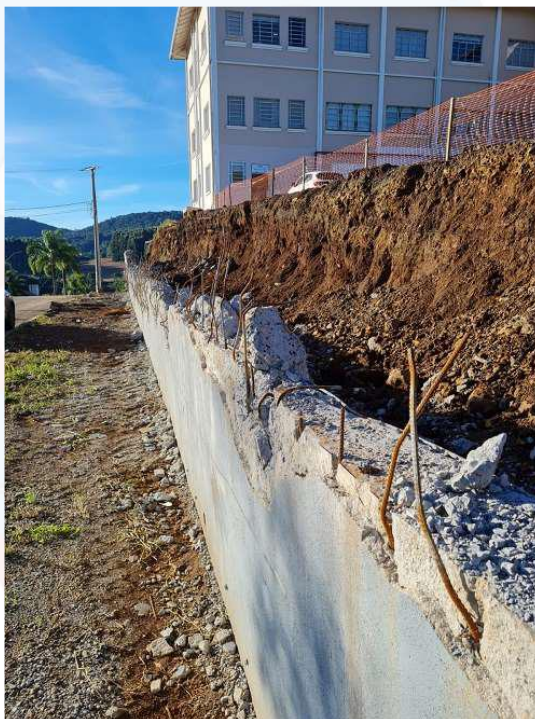
Figura 01: situação do muro atualmente
